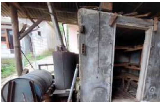
Gambar 6. Inovasi teknologi baru sistem boiler untuk pengukusan baglog
