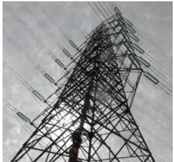
Gambar 1. SUTT 150 kV NRCKBA-UJBRG T.13
