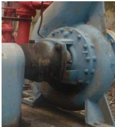
Gambar 18. Area Kebocoran Pelumas Bantalan
