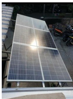
Gambar 4. Plts yang sudah terinstalasi
