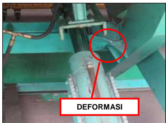
Gambar 9. Kegagalan dudukan cylinder hidrolis kanan atas pada trial pembebanan kedua
