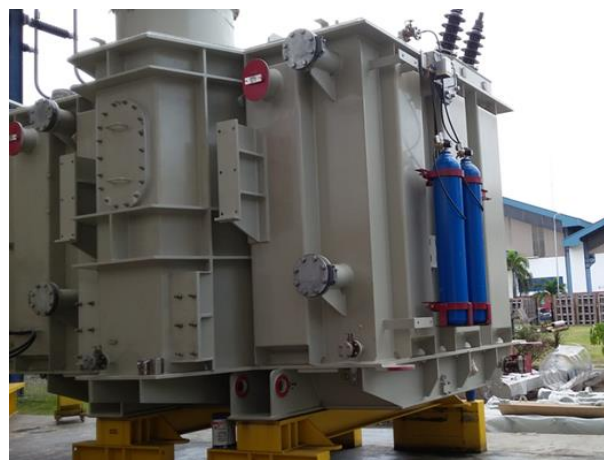
Gambar 4 Trafo Listrik Sumber: PT. XYZ, 2019
