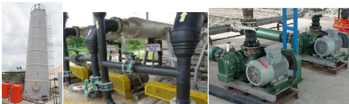
Gambar 4. Gas Handling; Scrubber H 2 S (kiri), Dehumidifier (tengah), Blower (kanan)
