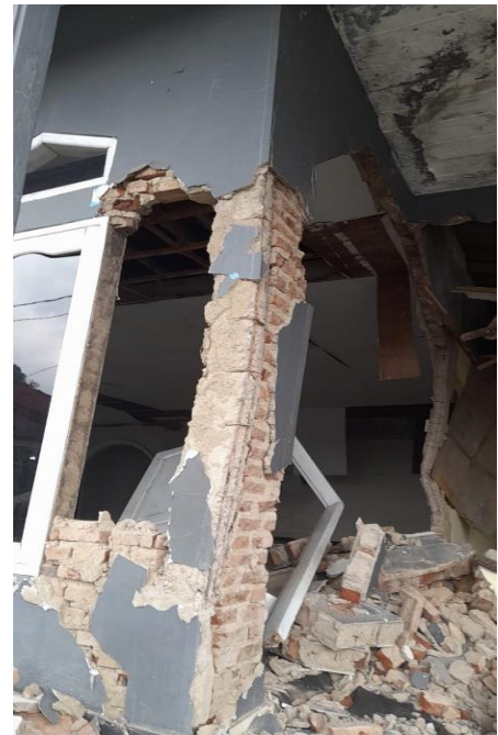
Gambar 3 Kolom dan dinding bangunan mengalami kerusakan
