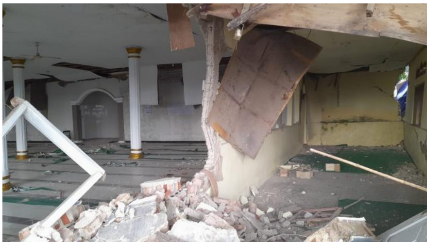
Gambar 2. Kerusakan akibat gempa Cianjur Sumber: Pribadi
