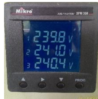
Gambar 15. Tampilan Alat Ukur untuk Nilai Tegangan per fasa tanggal 19 Juli 2016 pada Pukul 14:00 untuk Fasa I L3
