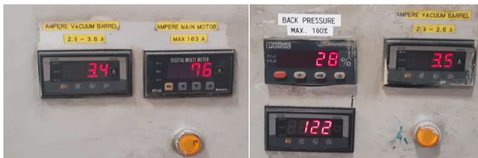
Gambar 2. Panel Sebelum (Kiri) Ditambahkan Indikator Backpressure dan Sesudah (Kanan)
