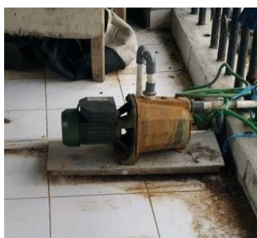
b. Kondisi Tempat Pompa Air
