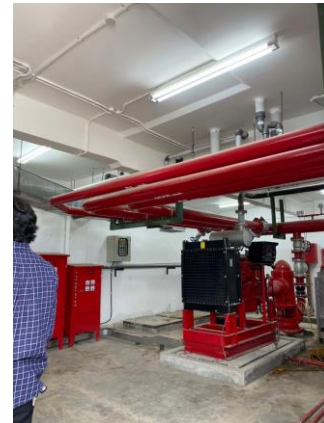
Gambar 12. Ruang MEP rumah susun Kampung Akuarium
