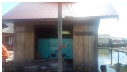
Gambar 8. Genset Komunal Sumber : DokumentasiTim Peneliti, 2022
