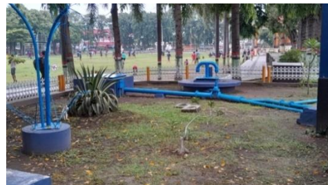
Gambar 28. Kondisi jaringan air bersih Sumber : Penulis, 2023
