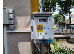
Gambar 27. Kondisi jaringan listrik Sumber : Penulis, 2023
