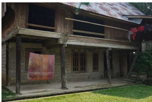
Gambar 27. Rumah R2 yang sudah mulai miring Sumber: Dokumentasi Pribadi, 2023
