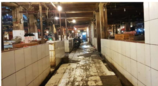
Gambar 15. Drainase tidak memiliki kemiringan sesuai dengan ketentuan yang berlaku (Sumber: Data Pribadi di Lapangan, 2020)
