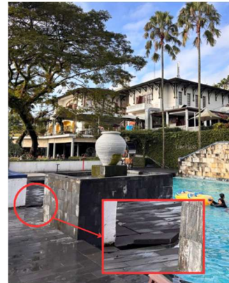
Gambar 8. Retakan Ubin Kolam Renang Sumber : Pribadi, 2025
