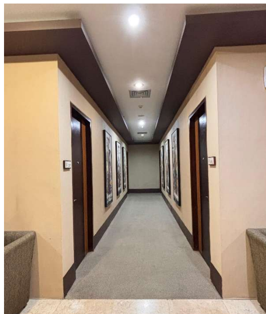
Gambar 24. Exhaust Fan Pada Koridor Kamar Hotel Sumber : Pribadi, 2025
