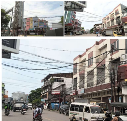
Gambar 5. Jaringan kabel utilitas udara pada koridor
