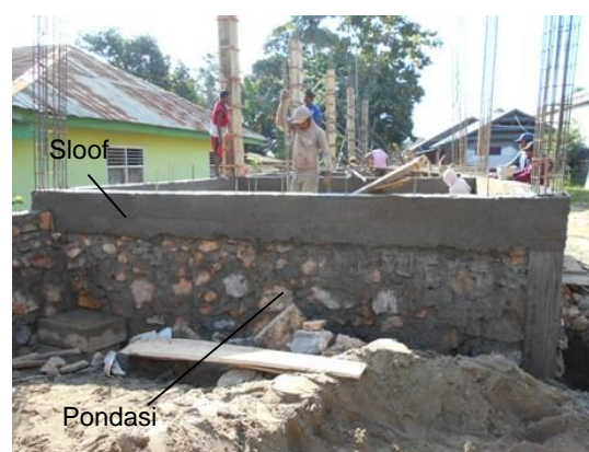
Gambar 2. Sloof dan pondasi batu gunung dibuat satu paket pada bangunan Rumah Toko di Kota Kendari
